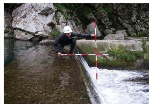
④左岸側本堤の落差状況
