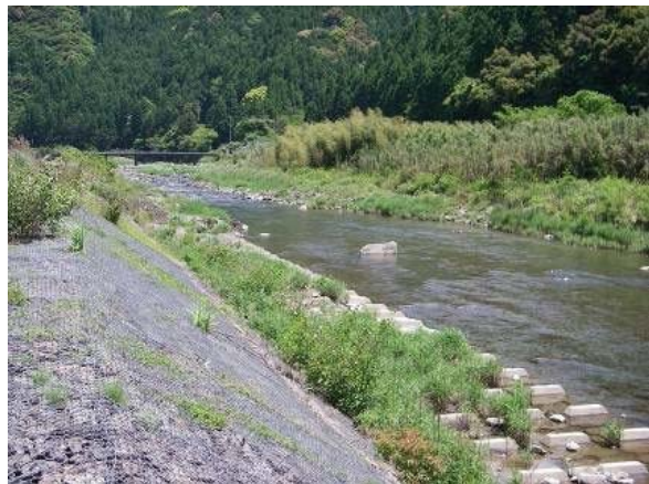
河床低下が確認された直線河道
