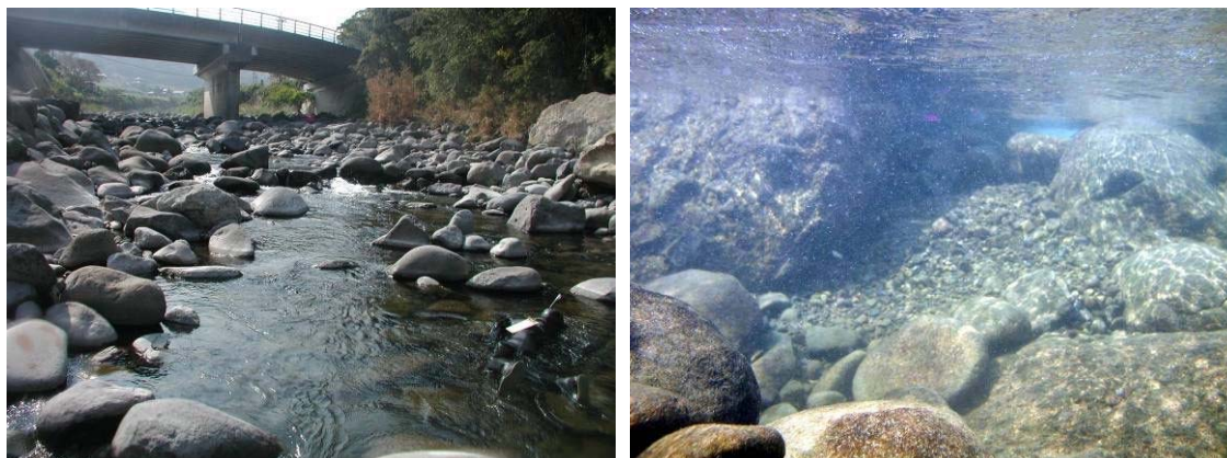
福岡県岩岳川に設置された分散型落差工（左）とその水中の状況（右） ステップ・プールが明瞭で小砂利がよく補足されている
