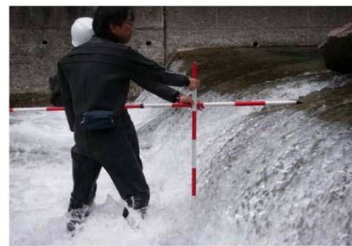
⑥右岸側本堤の落差状況
