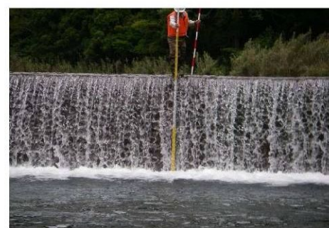
④本堤の落差状況
