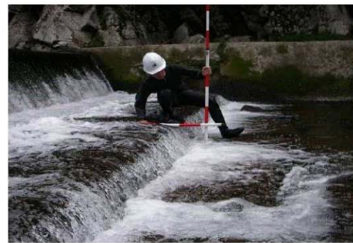
⑤左岸側水叩きの落差状況
