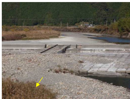
瀬切れ状態となった鴨田頭首工下流の状況
