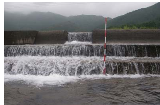
⑦落差の状況
