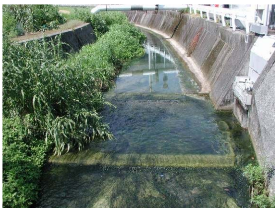
早稲川と右水門が水水浄化施設の取水口
