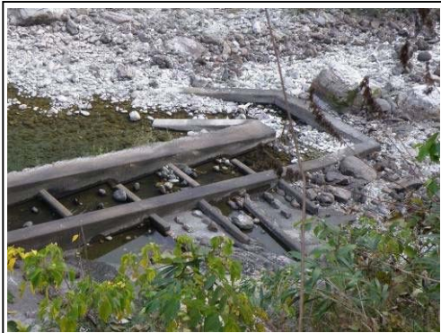
改善対策 ■魚道下流端の土砂除去
