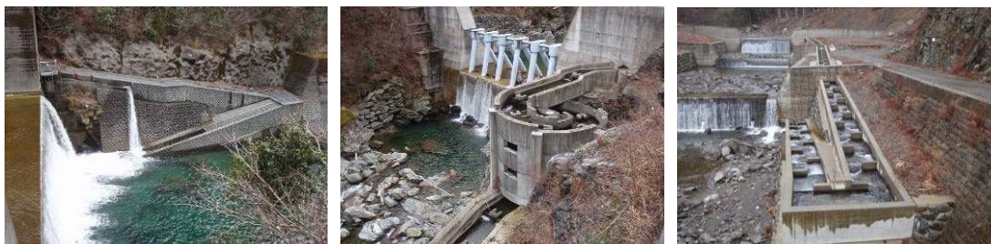
砂防堰堤に設置された魚道の事例
