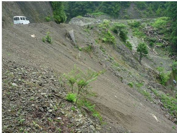
林道が発端になったと考えられる崩壊の事例。車が停車している山側には高い切土がある。谷側の土砂は絶えず移動しており、土砂の発生源であるとともに、植生の回復も難しい。
