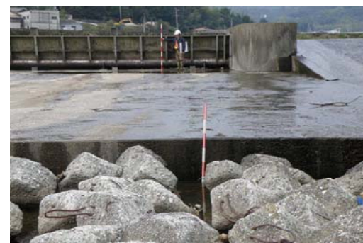
③右岸側の落差状況
