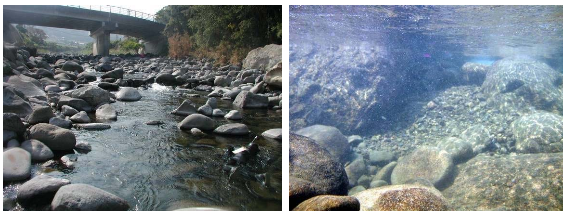
事例：福岡県岩岳川に設置された分散型落差工（左）とその水中の状況（右） ステップ・プールが明瞭で小砂利がよく補足されている
