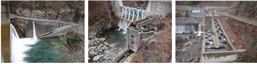
砂防堰堤に設置された魚道の事例
