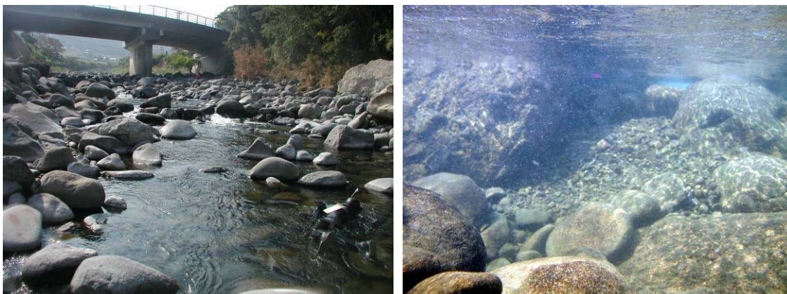
事例：福岡県岩岳川に設置された分散型落差工（左）とその水中の状況（右） 河床掘削後の河床の安定化と生物の生息環境の復元を目的に施工された
