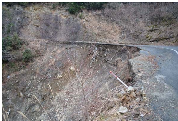
林道の谷部における崩壊。水が集まる場所は崩壊の危険性が非常に高い。
