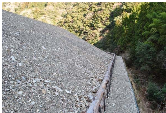
林道の開設により発生したと思われる土砂の土捨て場。河岸に積み上げられているため、土砂がここから流亡して河川に流入することが懸念される。緑化等の土砂流出対策は今のところ取られていない。
