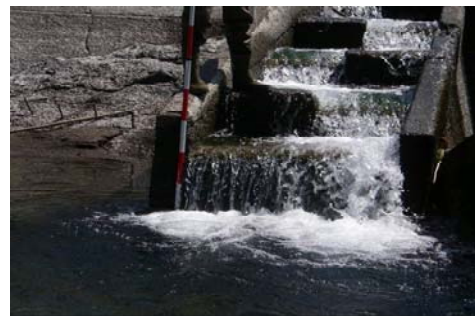
⑦右岸側魚道の下流端落差状況
