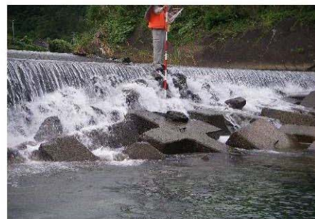
⑦本堤下流端の落差状況
