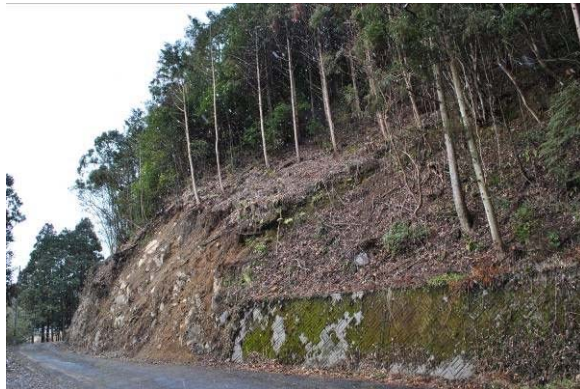
市道拡幅のために切り取られた上部がヒノキ人工林の斜面。切りっぱなしになっており、崩壊の危険性が高い状態にあると考えられる。(篠川下流域)
