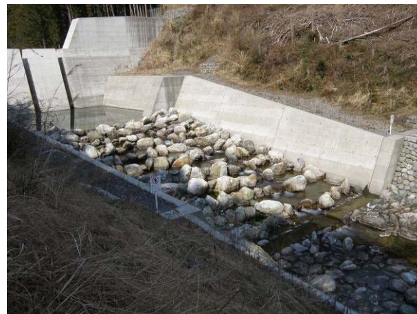
砂防堰堤に設置された階段式全断面魚道 仁淀川水系成川
