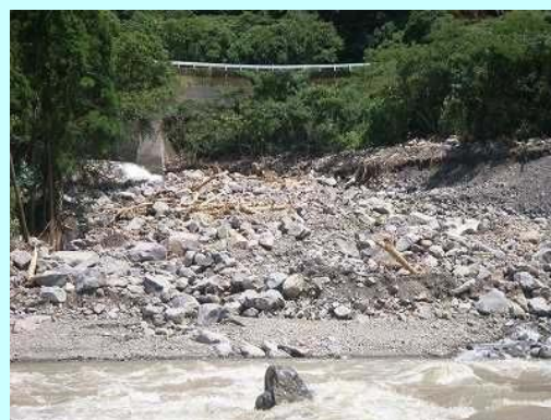
台風6号の降雨によって土石流が発生した平鍋地区の溪流
