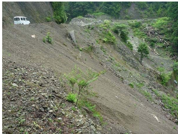
支川東川沿いの林道が発端になったと考えられる崩壊（魚梁瀬ダムバックウォーター付近）。車が停車している山側には高い切土がある。谷側の土砂は絶えず移動しており、土砂の発生源であるとともに、植生の回復も難しい。
