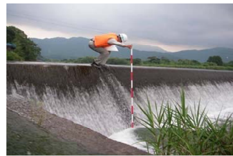
⑤ 右岸側本堤の落差状況
