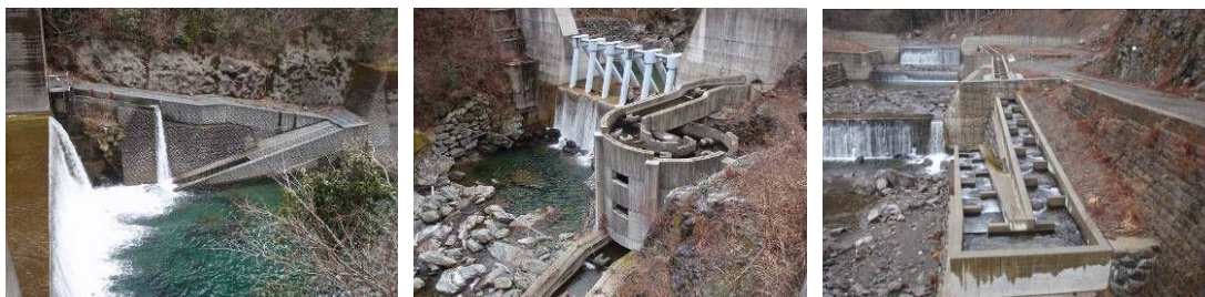
砂防堰堤に設置された魚道の事例
