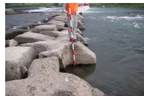
⑧ 護床ブロックの落差状況
