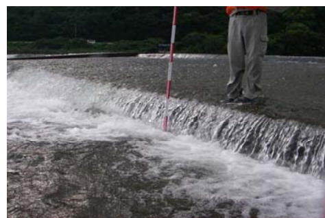
⑦ 左岸側堤の落差状況
